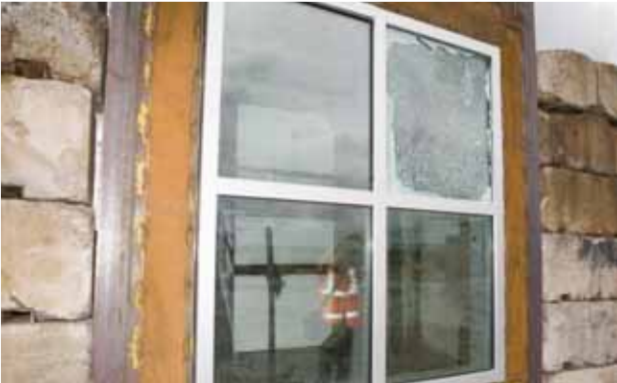
Patlamadan Sonra (Giydirme Cephesi)
